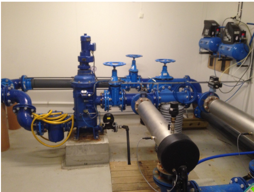
Bilde 4-6 , viser UV anlegget i Halså vannverk.
