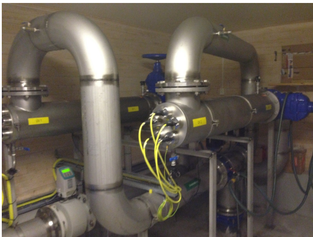
Bilde 4-2 , viser UV-aggregatet i Spildra vannverk slik det er i dag.
