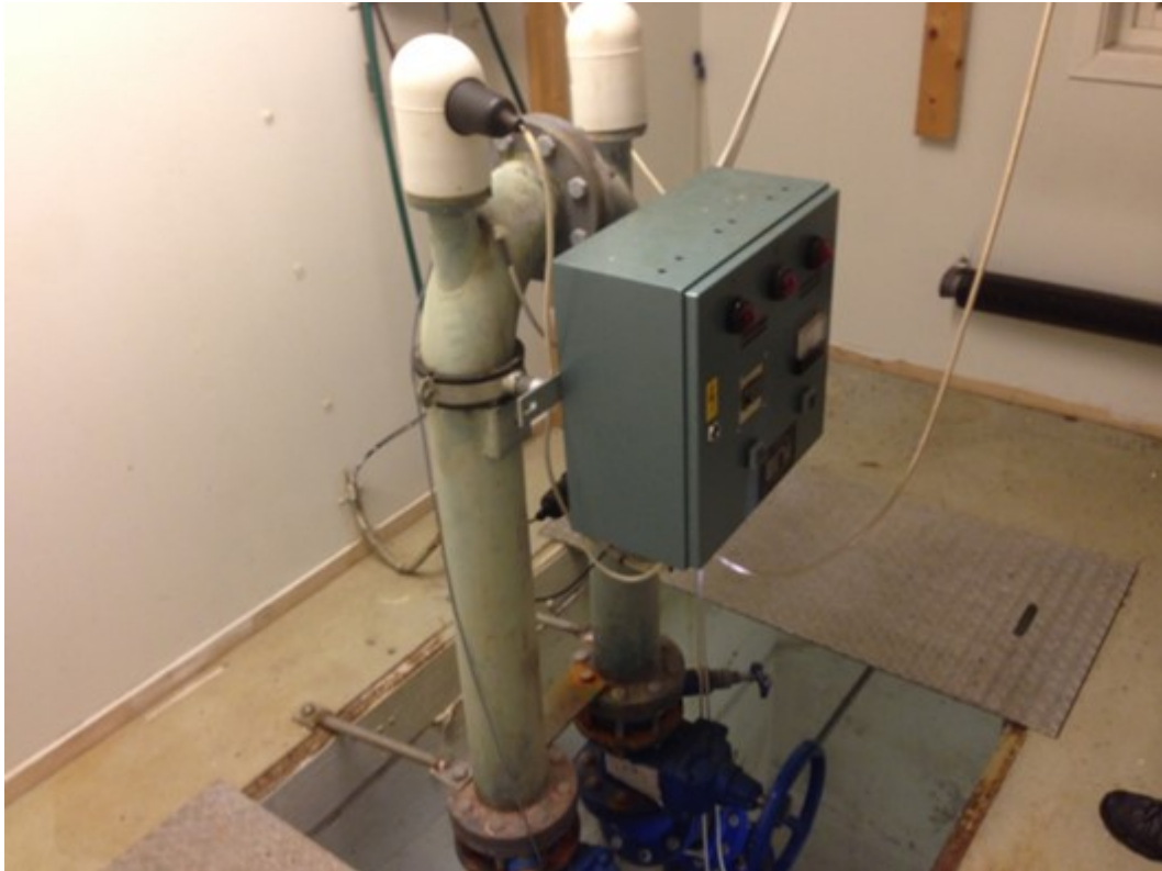
Bilde 4-4, viser UV-anlegget i Vassaksla
