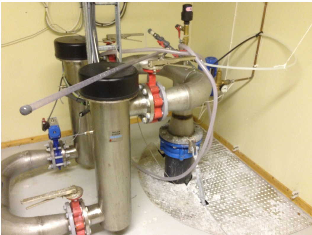
Bilde 4-7, viser UV-anlegget i Vassdal vannverk.
