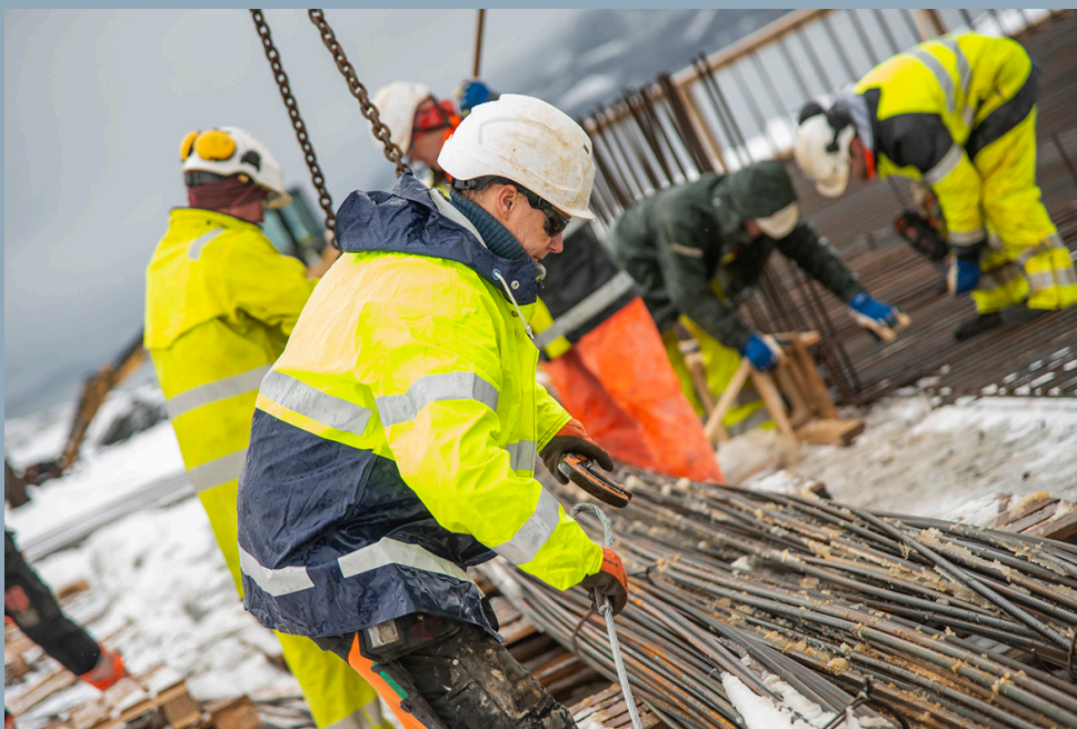
Halsa Bygg AS er blant de 12 største selskapene i Meløy. Foto: Ny Næring AS
